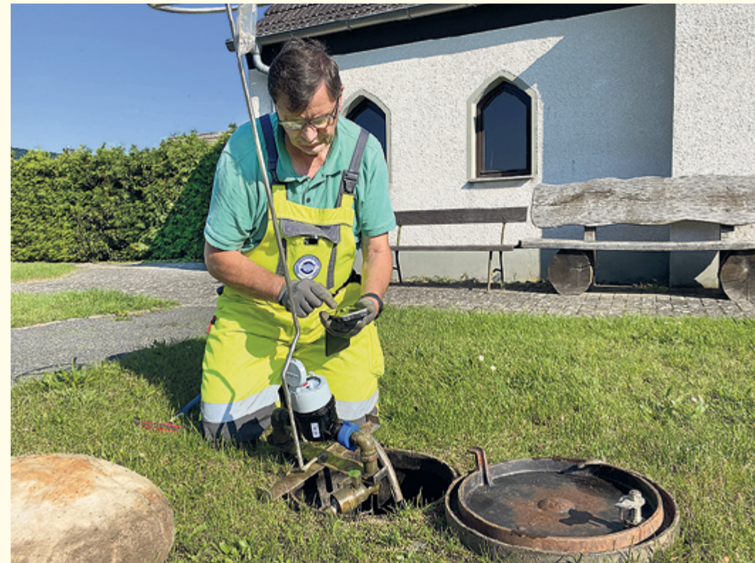
Auch auf einem Friedhof muss abgelesen werden. Hier, in Bückwitz, ist der Wasserzähler so im Schacht installiert, dass Frank Kämpfe ihn zum Ablesen problemlos herausziehen kann.
