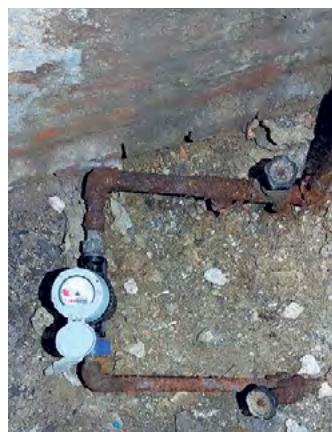
Diese verrottete Leitung würde beim Zählerwechsel auseinanderfallen.
